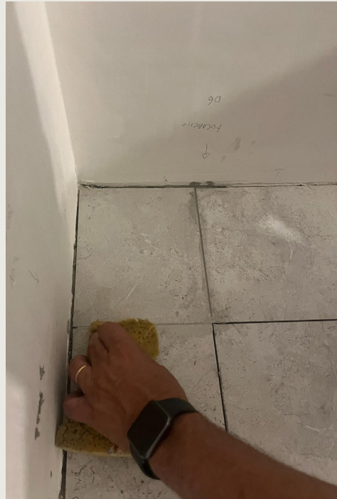
Fase di stesura durante la scelta per lo stucco delle fughe delle piastrelle.
